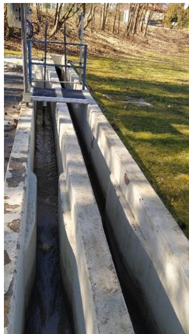
Abbildung 4: Zulaufbauwerk mit Venturi-Messrinne
