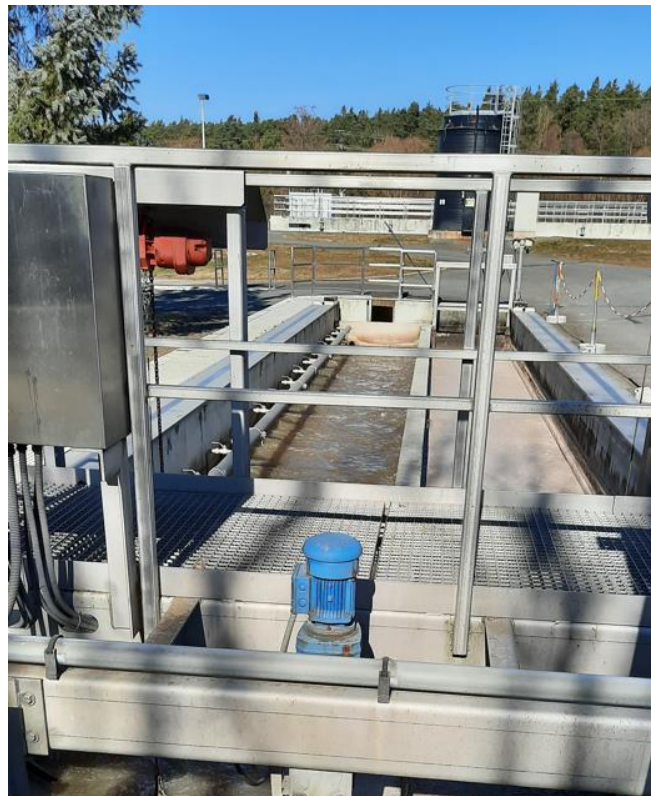
Abbildung 5: Belüfteter Sand- und Fettfang
