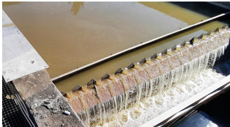
Abbildung 6: Ablauf des Vorklärbeckens über eine gezahnte Überlaufschwelle
