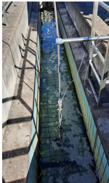
Abbildung 16: Ablauf der Kläranlage
